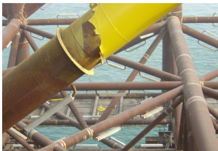
Fotografia 9. Fragment konstrukcji fundamentu typu jacket z przyspawanymi anodami
